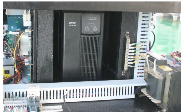
大功率 UPS 电源+隔离变压器
